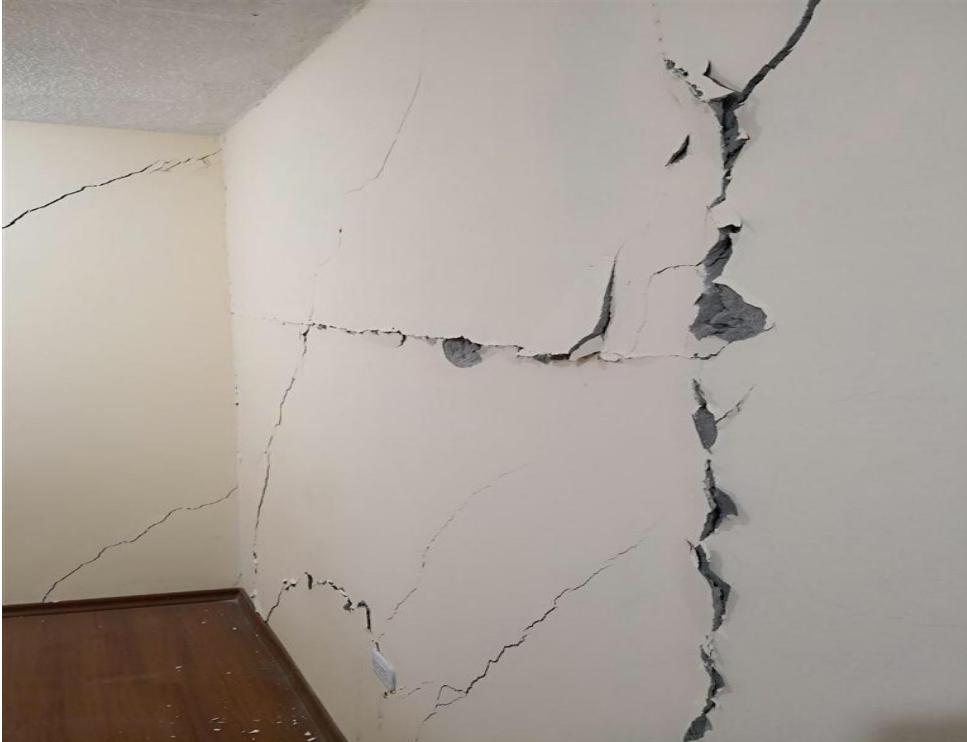
Casa con daños en su interior en Solanda
