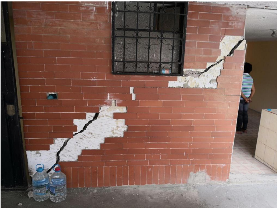
Casa con daños en parte exterior en Solanda
