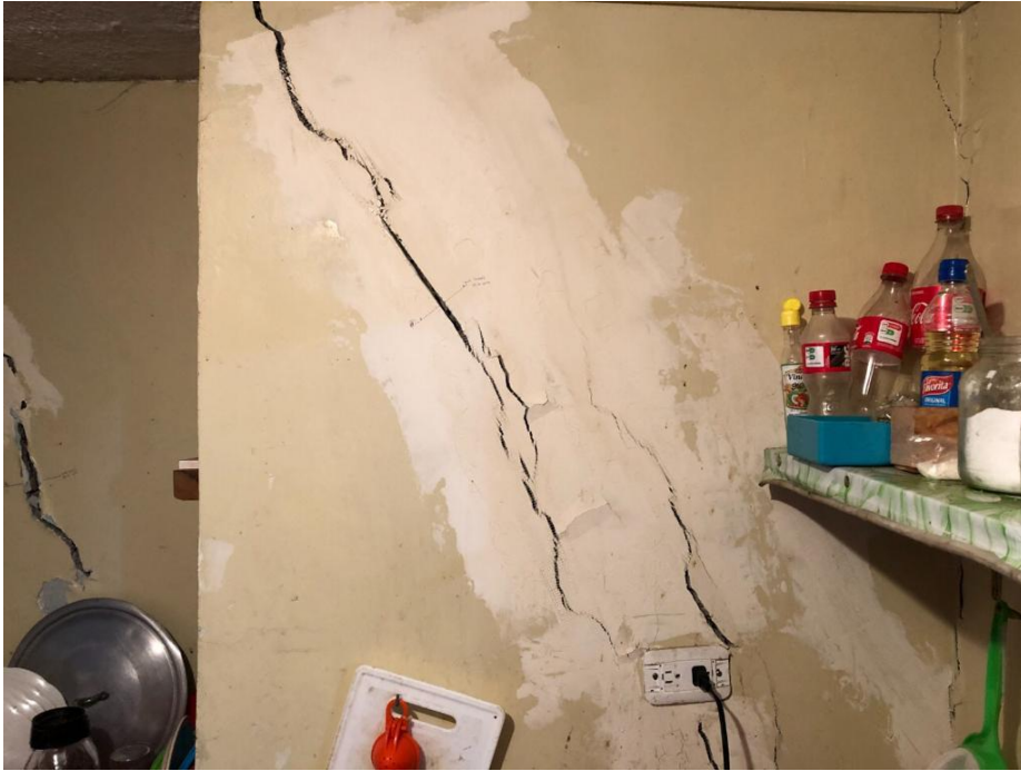
Casa con grietas y con reparación en Solanda
