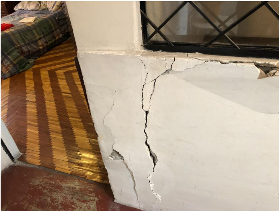
Casa con grietas en su interior en Solanda
