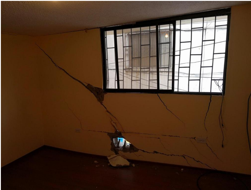
Casa con grietas internas en Solanda, sector uno.
