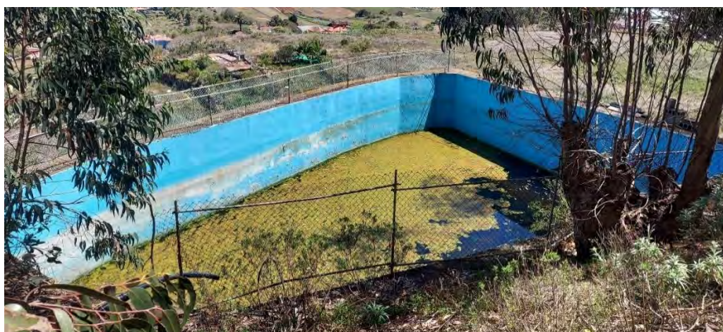
Fotografía 4. Deposito para recoger el agua de lluvia
