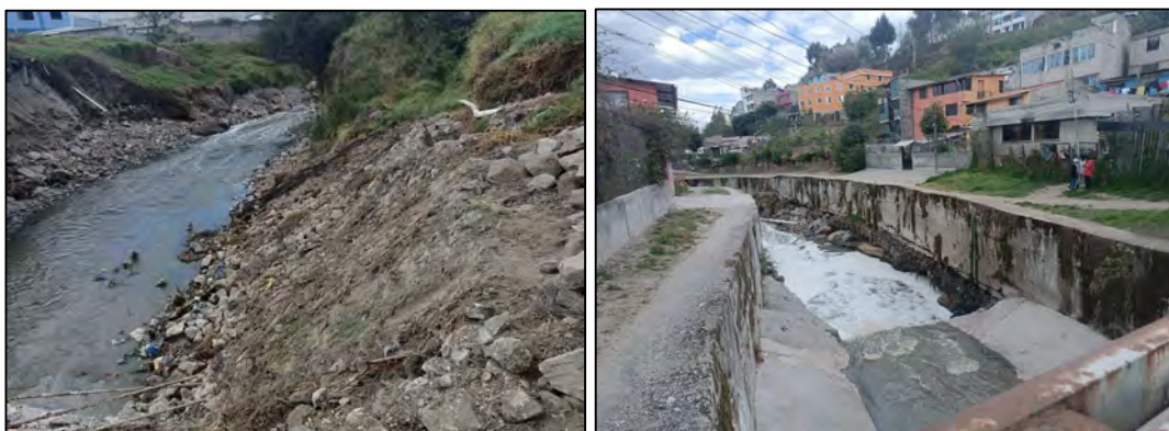
Figura 26. Tramos de la quebrada El Capulí y viviendas cercanas Fuente: fotografías tomadas durante las visitas de campo en noviembre 2024
