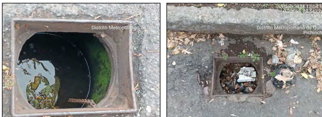
Figura 27. Ejemplos de infraestructura de drenaje convencional deterioradas, Turubamba Bajo Fuente: fotografías tomadas durante las visitas de campo en diciembre 2024
