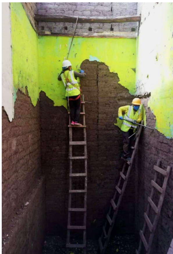
Figura 19. Cristina y Rosi retiran el enlucido de toda la casa. 2021. Fotografía tomada con teléfono por Florencia Sobrero en San Tola.
