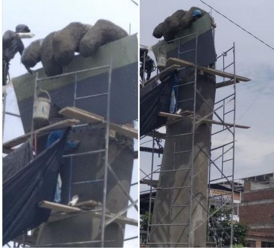
Figura 6. Proceso de Construcción del monumento Resiste , Puerto Rellena, Cali, Colombia, Teresa Consuelo Cardona 2021. Fuente Red social Facebook.
