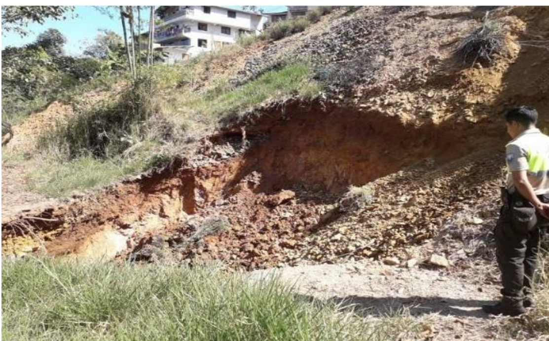
Descripción de la fotografía: Hundimiento de Tierra, con 10 metros de diámetro y 3 metros de profundidad, producido en agosto del 2019 a 100 metros de la calle Gonzalo Pizarro. Imagen tomada de la página web del diario El Universo. ( https://www.eluniverso.com/noticias/2019/08/02/nota/7453881/socavon-inquieta-habitantes-zaruma-provincia-oro/ ).
