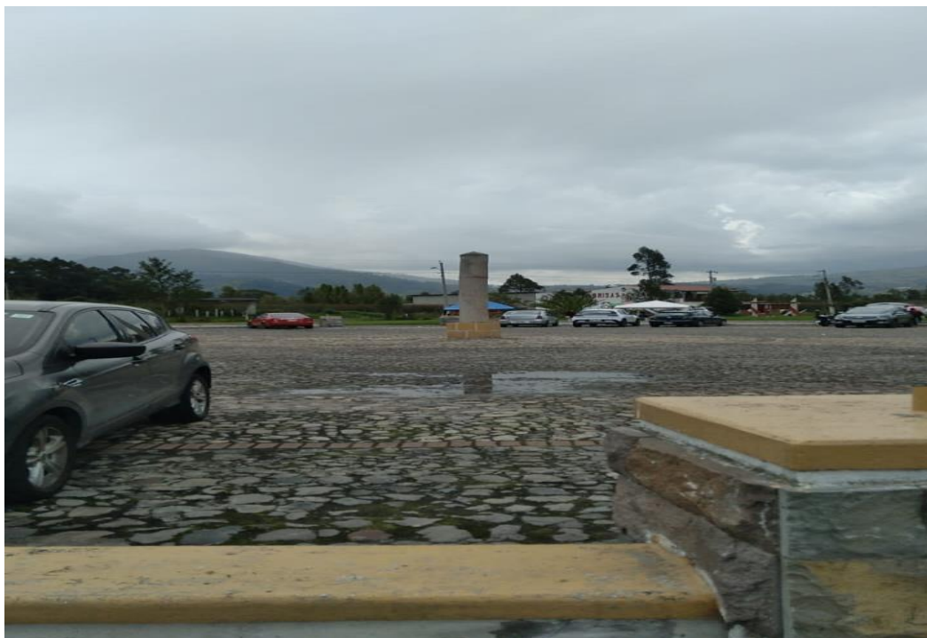
b) Espacio ceremonial afectado por precipitaciones, abril 2023.
