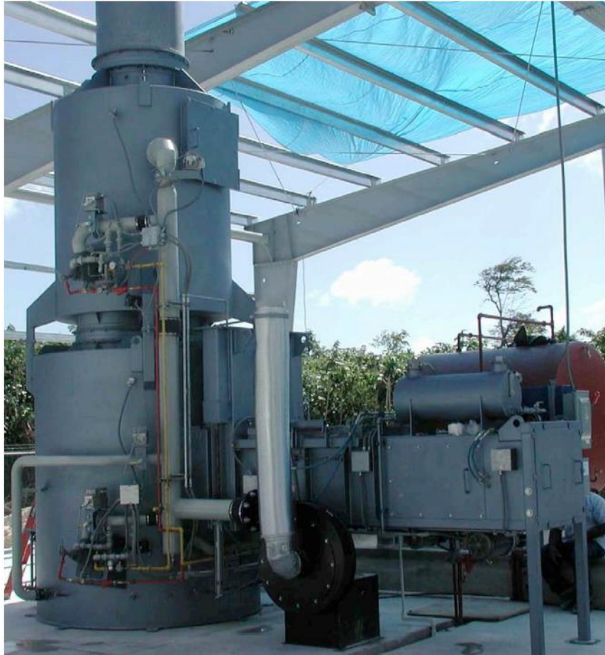
Figura 8. Incinerador marca Pennram E180
